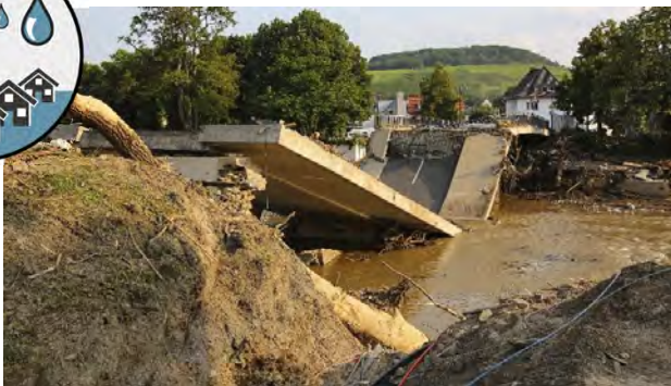
Zerstörte Brücke im Ahrtal. picture alliance/dpa / Bodo Marks
