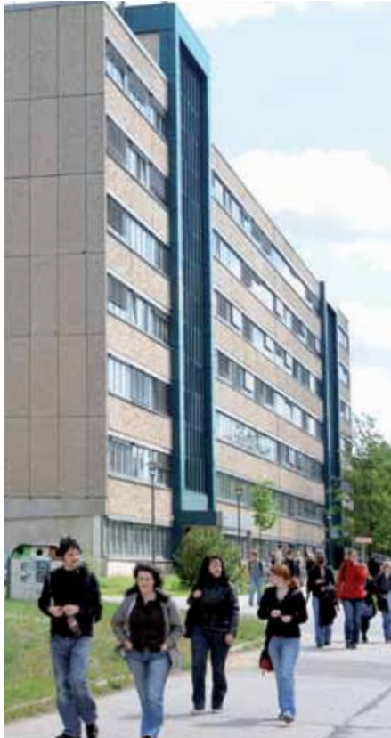
Soll demnächst saniert werden: die wärmedurchlässige Plattenfassade des Hauses 14 in Golm.
